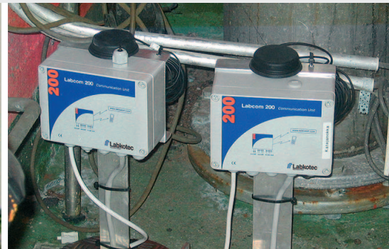
▲ Labcom 200 –tiedonsiirtoyksiköt lähettävät mittaukset ja hälytykset kaukovalvontajärjestelmään.
